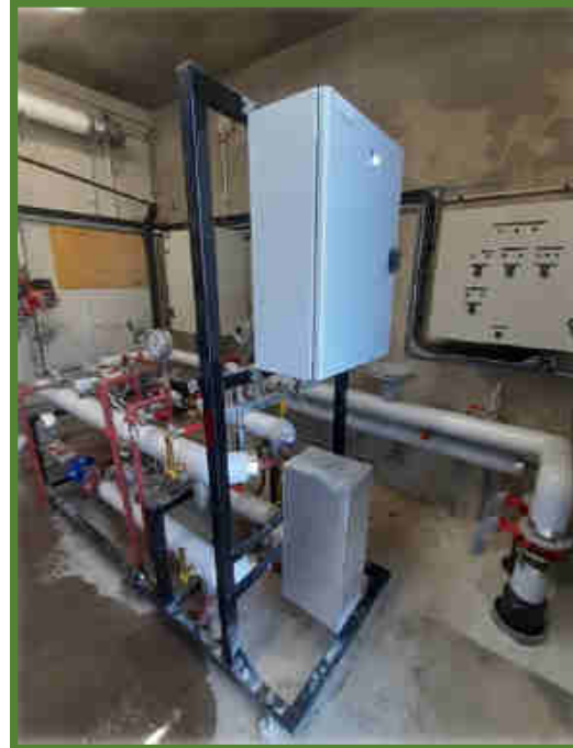
Sous station d'échange de calories entre le réseau primaire (réseau public) et le réseau secondaire (réseau privé).
