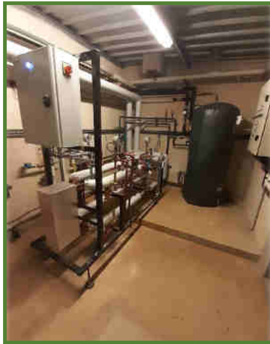
Sous station d'immeuble avec ballon d'eau chaude sanitaire
