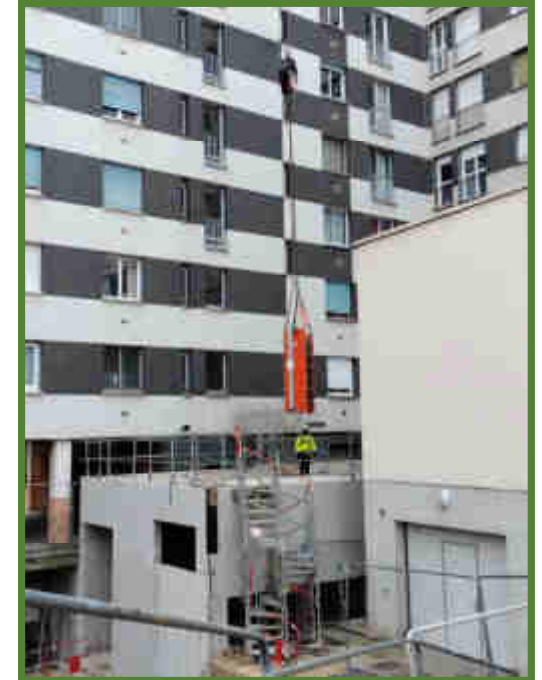
Sous station d'échange sur des Ursulines entre les réseaux Syner'gie et Mans nord en'gie (échange de chaleur renouvelable – UVED et biomasse)
